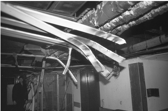
Bild 1: Brand einer Druckluftleitung in der Installationsdecke
